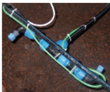
Varmekabel i biofilteret
