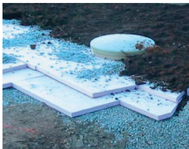
Figur 17: Frostsikring av tanker
