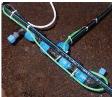
Varmekabel i biofilteret
