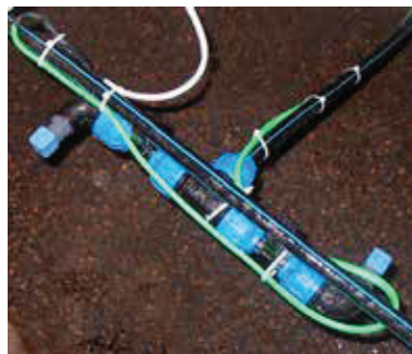
Varmekabel i biofilteret
