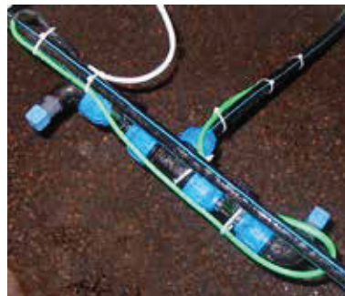
Varmekabel i biofilteret
